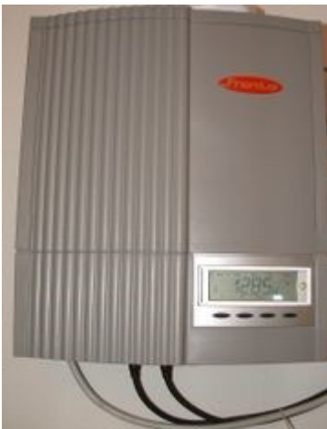
Wechselrichter: Netzeinspeisung von Fotovoltaik
